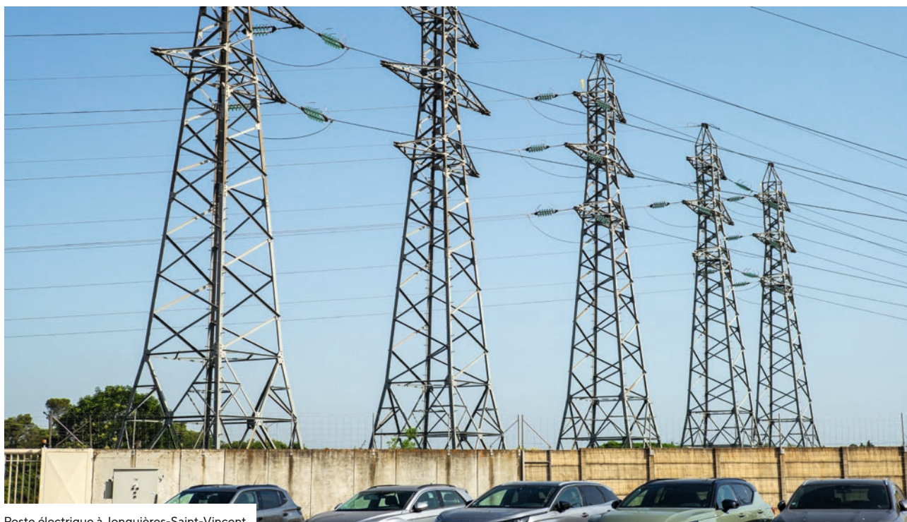
Poste électrique à Jonquières-Saint-Vincent
